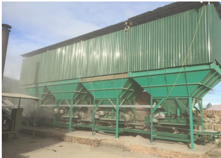
Hình 2. Tôn che chắn 4 phía của khu vực các phễu nhập liệu
